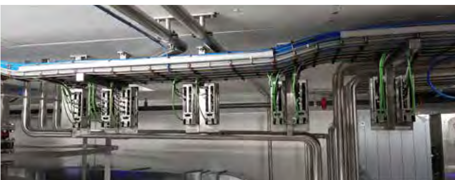
Die TBEN-I/O-Blockmodule sind platzsparend unter den Kabeltrassen in ATEX-Schutzgehäusen installiert
